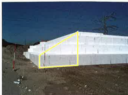
Constructief onnodige taluds van EPS-blokken: het gedeelte tussen de gele lijnen.
